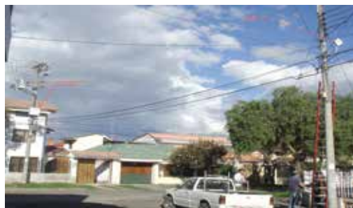
Figura 4: Reconector SIEMENS Av. Cacique Chaparra supervisado y controlado desde el Centro de Control
