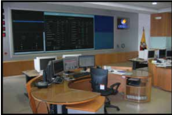
Figura 1: Sala de Control CENACE
