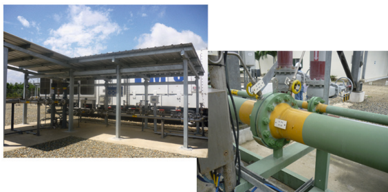
Figura 3: Sistemas de Medición de Combustible en la Planta de Generación Eléctrica
