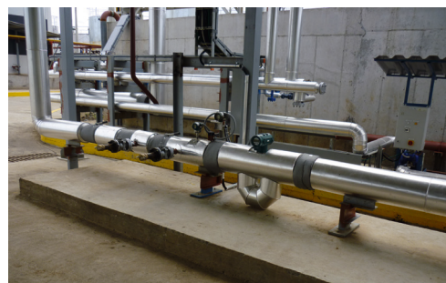
Figura 1: Sistema medición implementado para medición de combustible en tuberías
