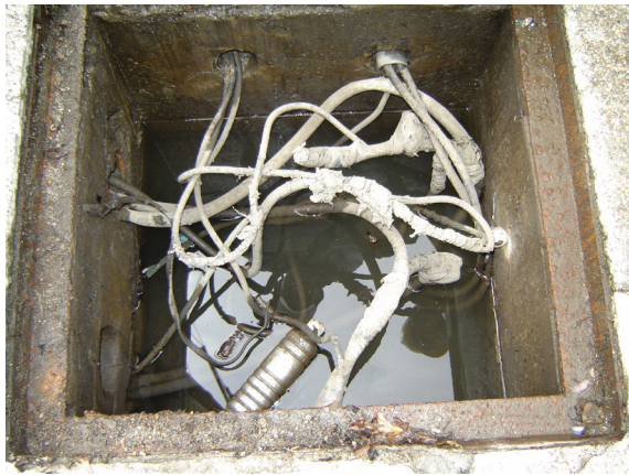
Figura 1: Conexiones de acometidas de baja tensión corroídas y quemadas en las que se utilizaron conectores de compresión y cintas autofundentes y cintas de vinyl
