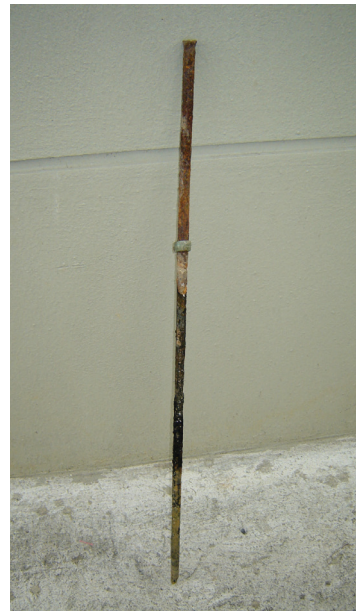
Figura 4: Varilla de puesta a tierra corroída y rota en su longitud por el efecto de corrosión galvánica
