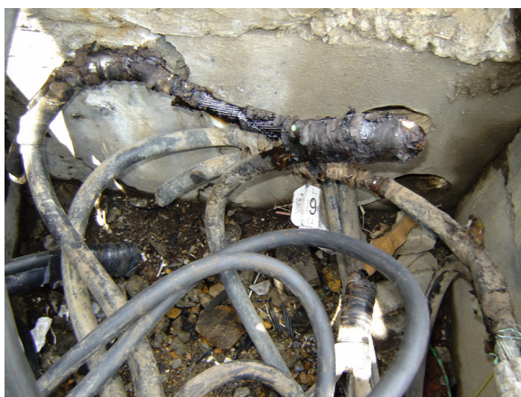
Figura 2: Conexiones de acometidas de baja tensión quemadas en las que se utilizaron conectores de compresión y cintas autofundentes y cintas de vinyl
