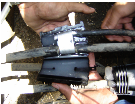
Figura 6: Implementación de conectores UDC con envolturas plásticas de gel en la conexión de acometidas de baja tensión
