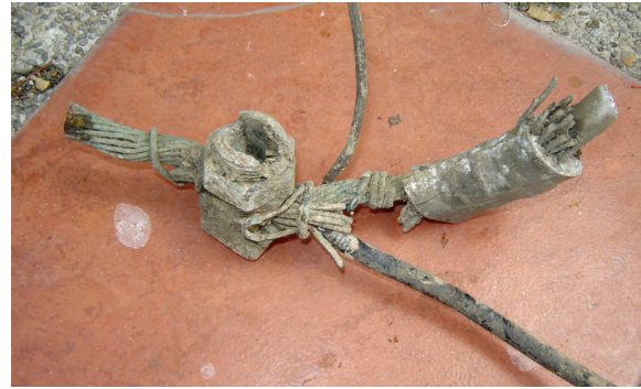
Figura 3: Grilletes corroídos usados en conexiones de acometidas de baja tensión en redes subterráneas
