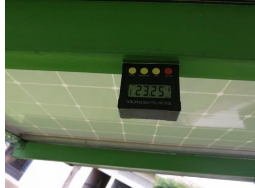
Figura 3: Ángulo de inclinación de los paneles fotovoltaicos ubicados U.P.S.
