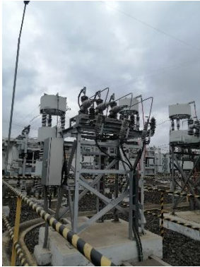
Figura 5: Reconectador Schneider serie U27 27 kV/ 630 A/ 125 kV-Bil / Isc 12 kA instalado en patio
