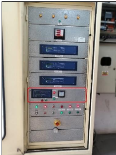
Figura 16: Tablero de control de compensación reactiva de la quinta armónica (cuadro de color rojo)
