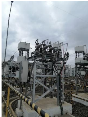
Figura 5: Reconectador Schneider serie U27 27 kV/ 630 A/ 125 kV-Bil / Isc 12 kA instalado en patio
